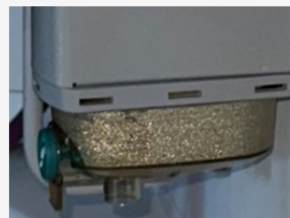
Figura 4: Condensação do reservatório.
